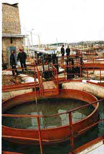
Первинний радіальний відстійник очисної споруди у Малині.
